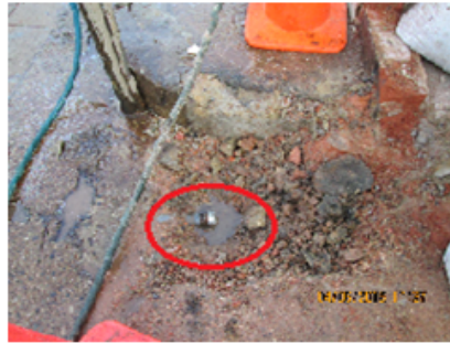
Foto No. 6. Vista del extremo de la tubería de producción, sellado con tapón roscado, que quedó enterrado bajo el piso de la zona de lavado de vehículos.
