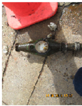
Foto No. 4. Vista general del medidor, desinstalado.
