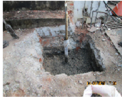
Foto No. 7. Vista de la caja perforada para la cimentación del sello sanitario.
