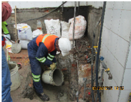
Foto No. 8. Vista del llenado de las tuberías con mezcla de bentonita y cemento gris.
