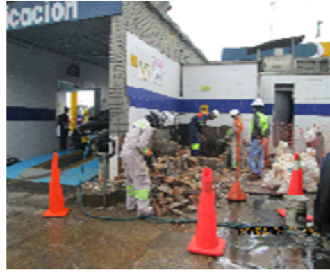
Foto No. 2. Vista del área donde se localiza la boca del pozo identificado con código pz-09-0034. Se observan las actividades de demolición de tanques de almacenamiento y tratamiento de agua que provenían del pozo.
